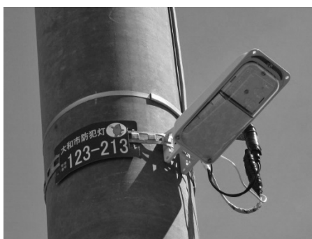
防犯灯管理プレート(6桁の管理番号)
