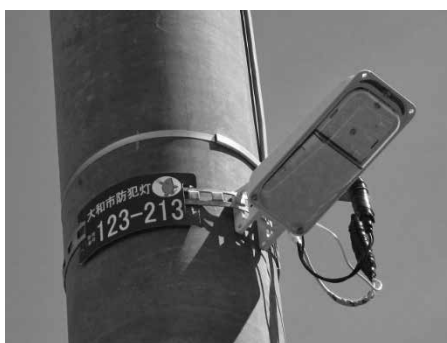
防犯灯管理プレート(6桁の管理番号)
