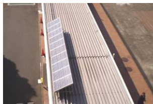
※大和市役所に設置している太陽光発電パネル
