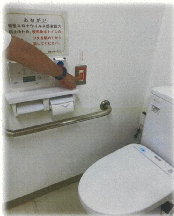
毎月 1 日 多目的トイレ非常用ブザー作動点検
