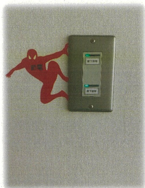
館内廊下のスイッチ
