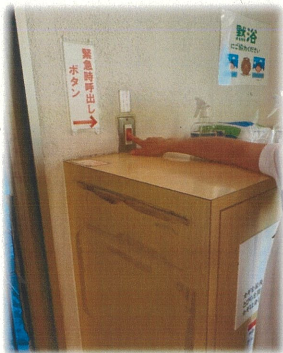
毎月 1 日 浴室非常用ブザー作動点検
