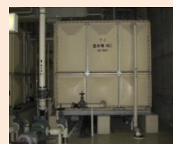
(パネル式受水槽)
