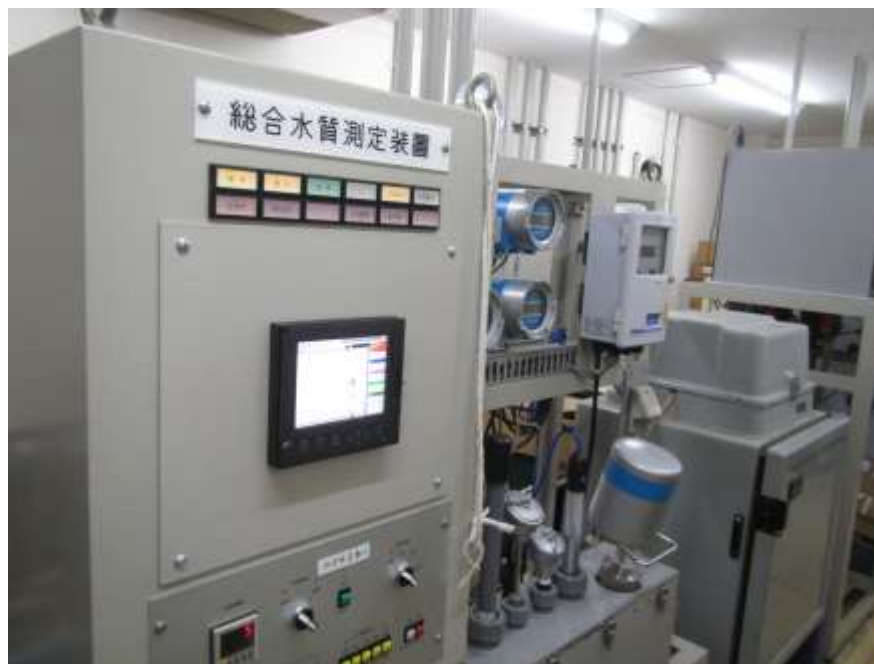
水質自動監視装置
