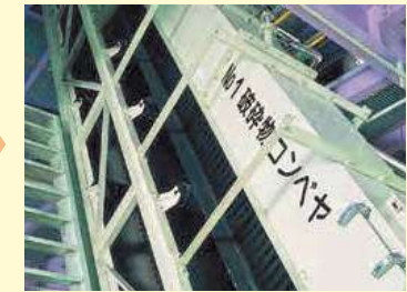
●No.1 破碎物搬送コンベヤ
