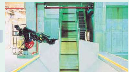
●不燃ごみ受入コンベヤと処理不燃物搬出装置
