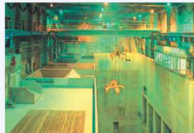
●ごみピット、自動ごみクレーン
