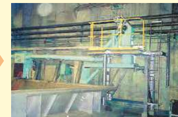
●パイプコンベヤ
