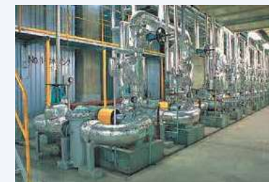
●ボイラ補機室
