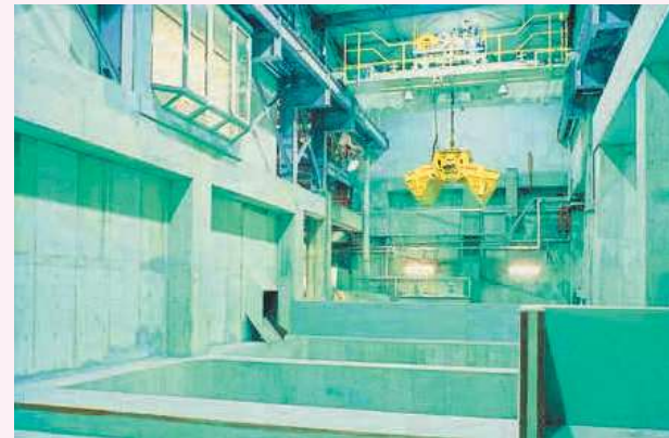
●ごみピット、クレーン
