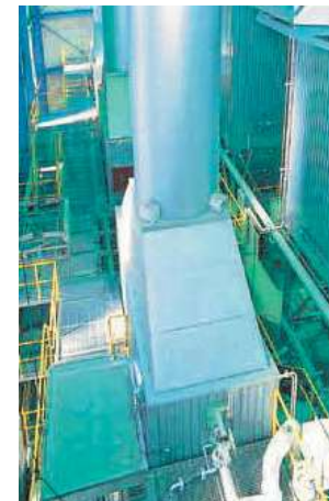
●触媒脱硝反応塔
