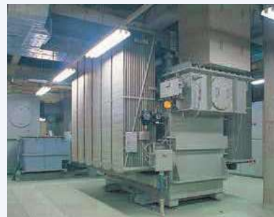
●特高受変電室
