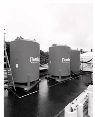
厚木航空施設が調整池に設置した粒状活性炭フィルター
