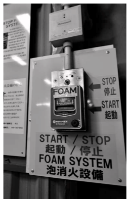
誤作動が起きた泡消火設備の制御盤
