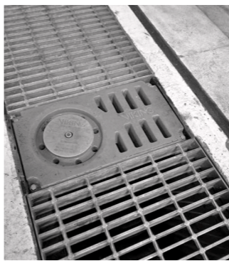
格納庫床面の泡消火剤放出口。泡消火設備が作動すると泡消火剤が斜め上方へ放出される
