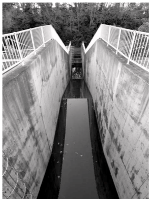
調整池から夢川へつながる水門
