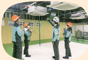
揺れ止め施工の有無で、 地震による空調設備の 揺れがどう違うか比較
