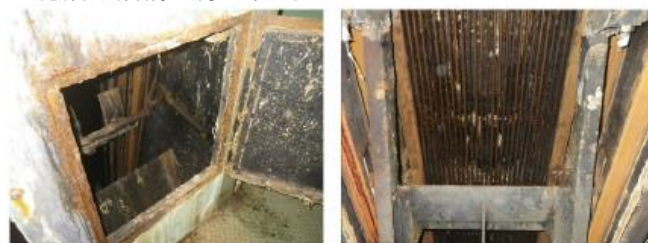
■施設・設備の劣化状況
