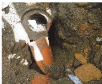
■管きよの破損事例
