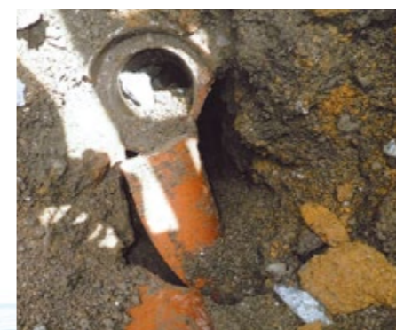
下水管が破損している様子
