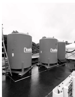
厚木航空施設が調整池に設置した粒状活性炭フィルター
