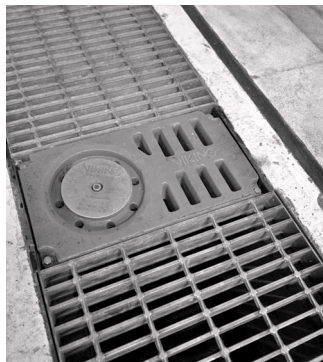
格納庫床面の泡消火剤放出口。泡消火設備が作動すると泡消火剤が斜め上方へ放出される
