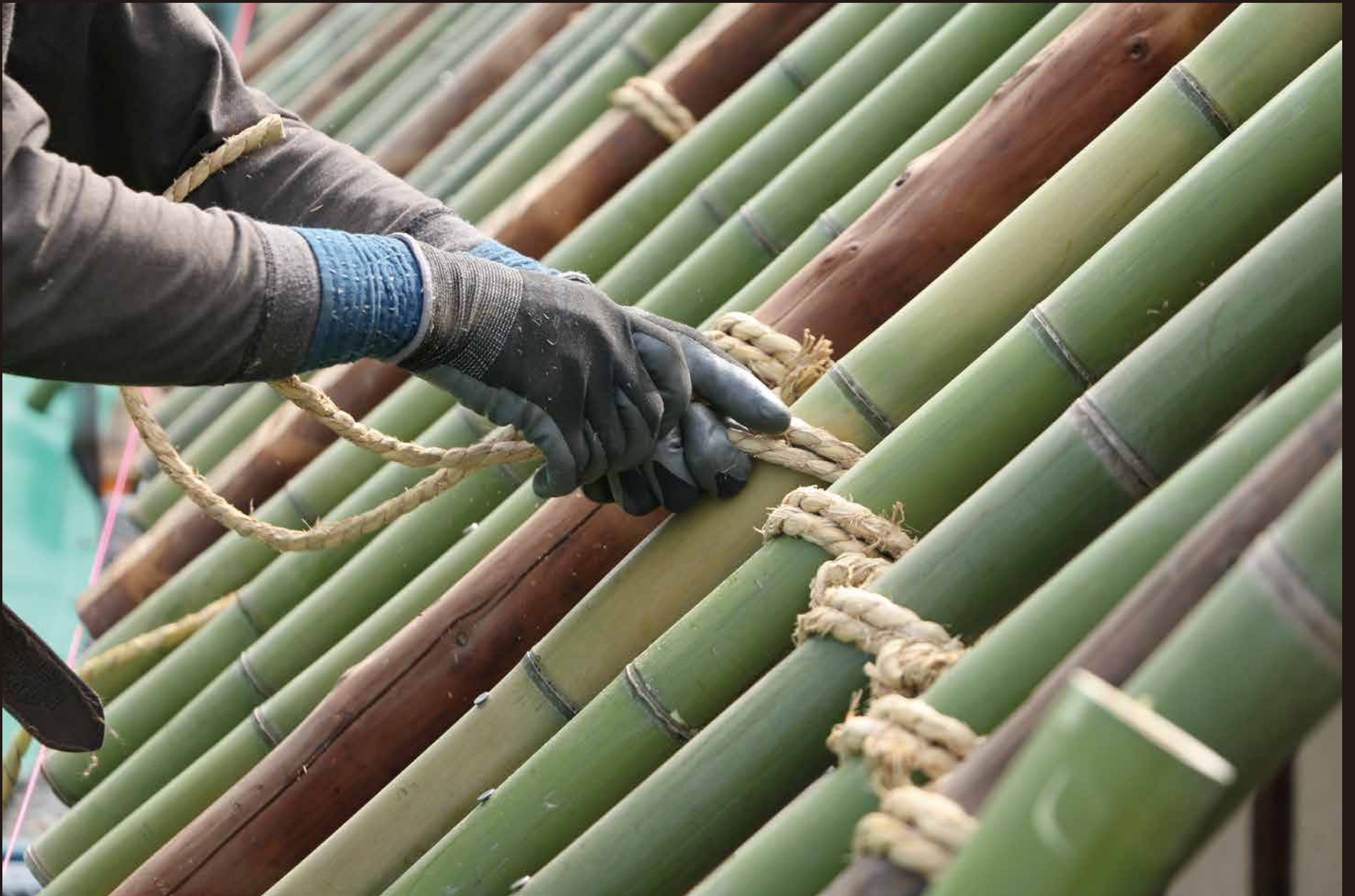
下地の竹や木材が交差する部分 1 か所 1 か所を職人が縄で縛ります。縄は質の良い福井県産の荒縄を使用しています。（屋練り | 2021 年 3 月 16 日撮影）
