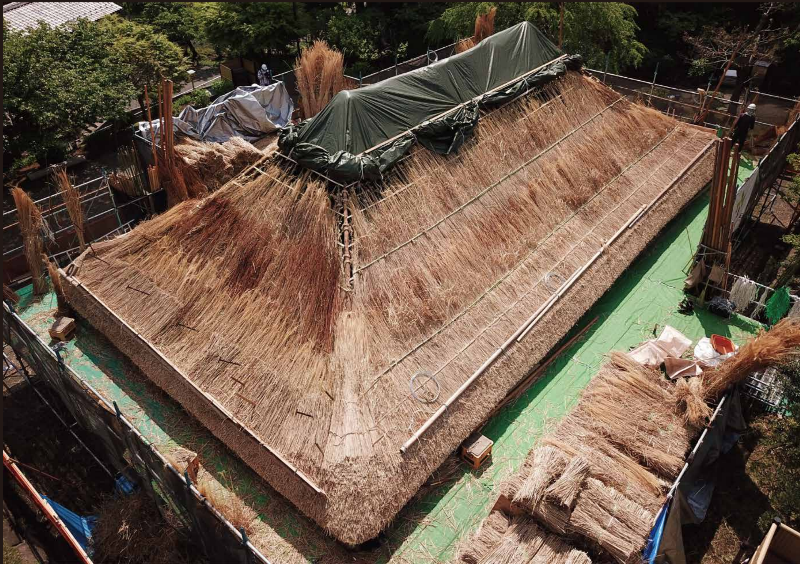
軒の上に茅の切り口が揃えられた面ができてきました。横にかけてられている丸太は作業の足場で、ここに乗りさらに屋根面を葺いていきます。(茅葺き | 平を葺く | 2021年4月8日ドローン撮影)
