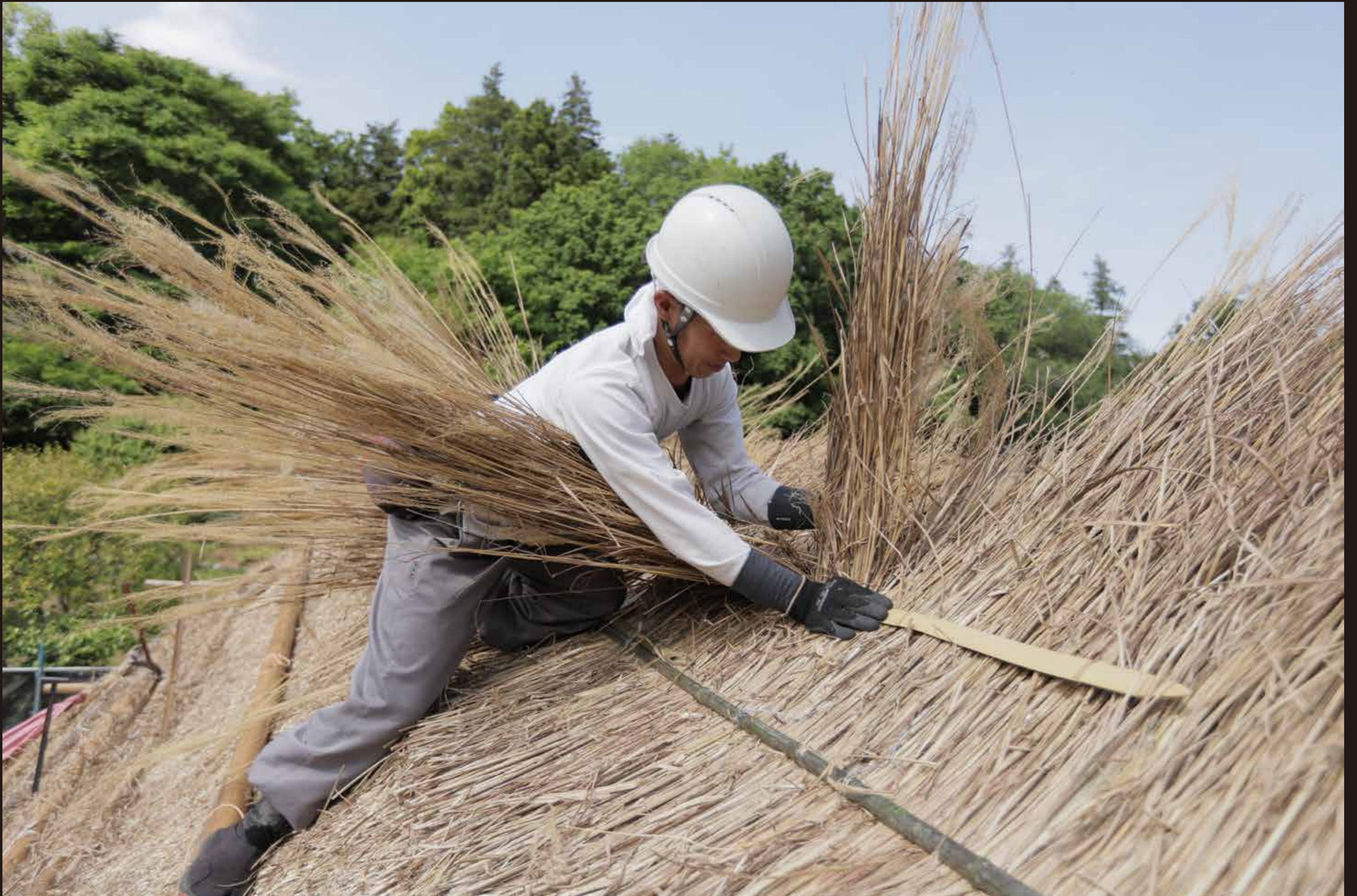
屋根の東側と西側から葺き上がった茅が棟（むね）に集まります。それを交互に編み込んで重ねていきます。「小まるき」とよばれる作業です。（棟づくり | 2021年5月6日撮影）
