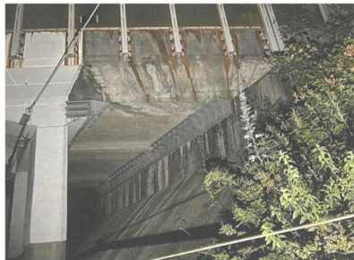
橋梁等の劣化状況 補修前
