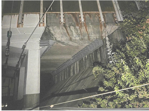
橋梁等の劣化状況(福田相模原線) 補修前
