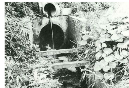
排水の未整備
