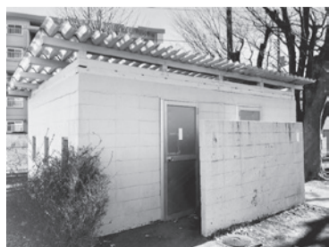
老朽化している外トイレ(西鶴間小)
