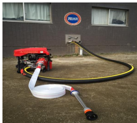
【可搬式消防ポンプ設置例】
