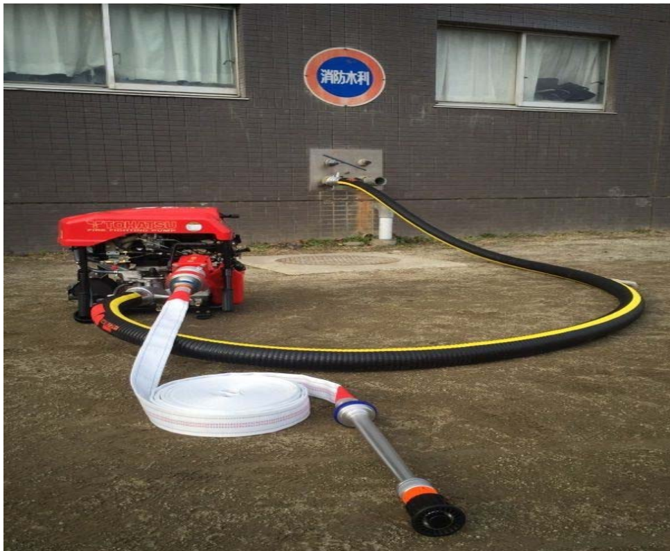
【可搬式消防ポンプ設置例】
