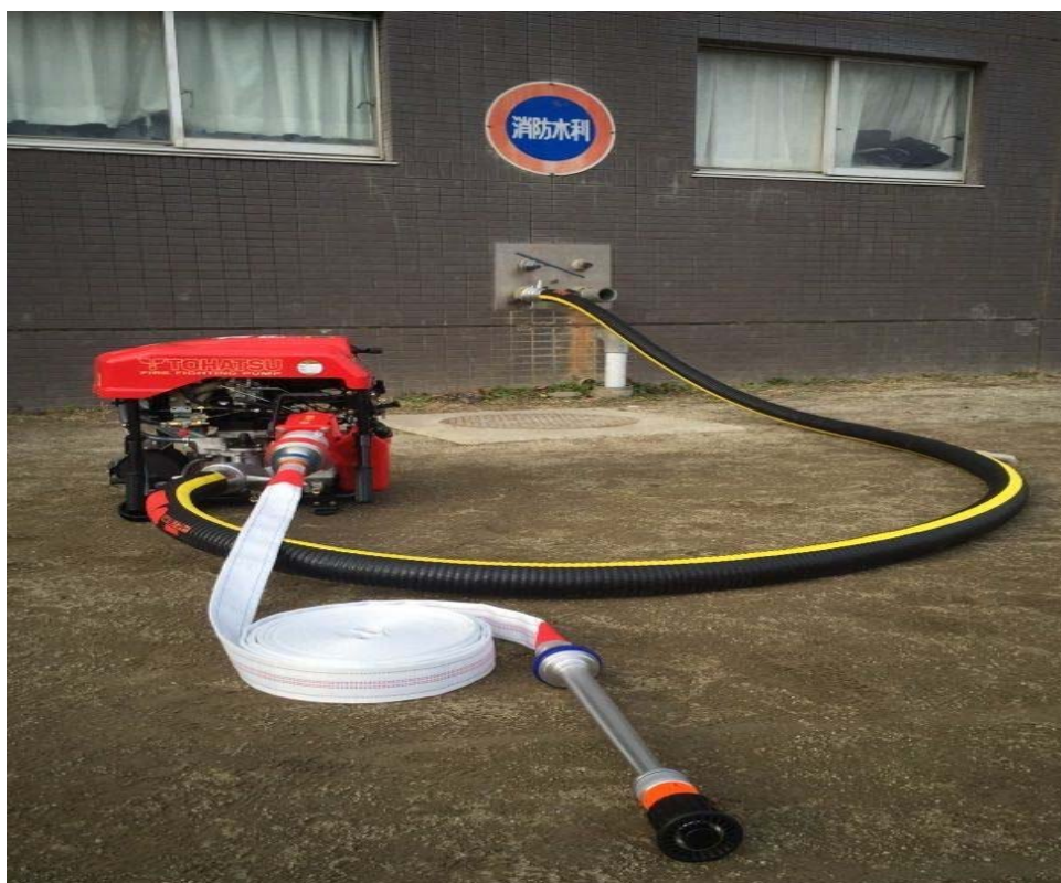
【可搬式消防ポンプ設置例】
