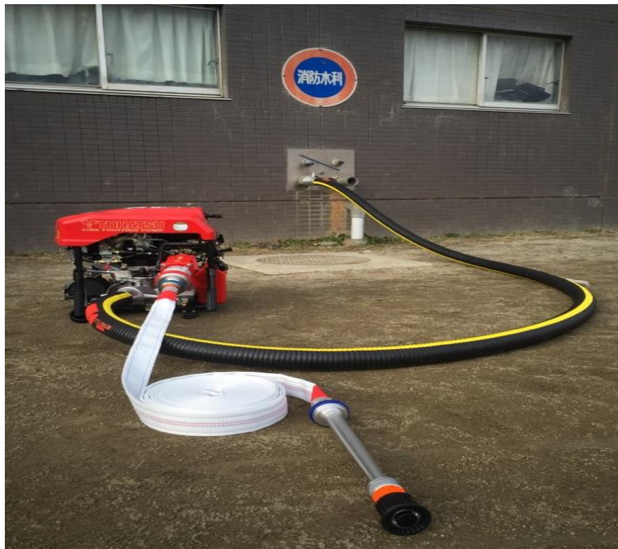
【可搬式消防ポンプ設置例】
