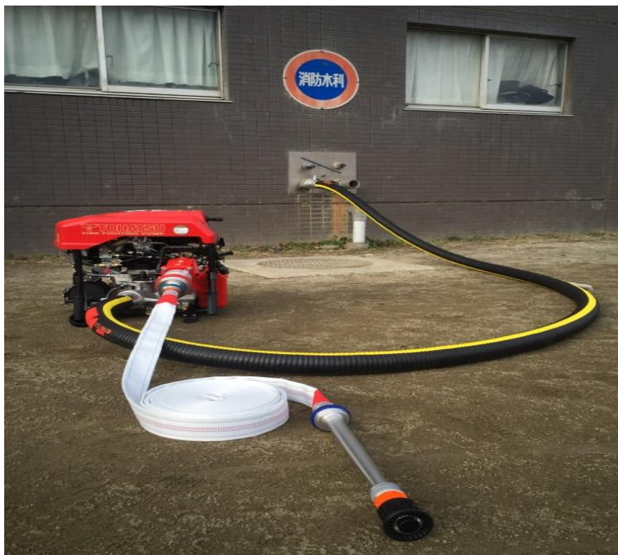
【可搬式消防ポンプ設置例】
