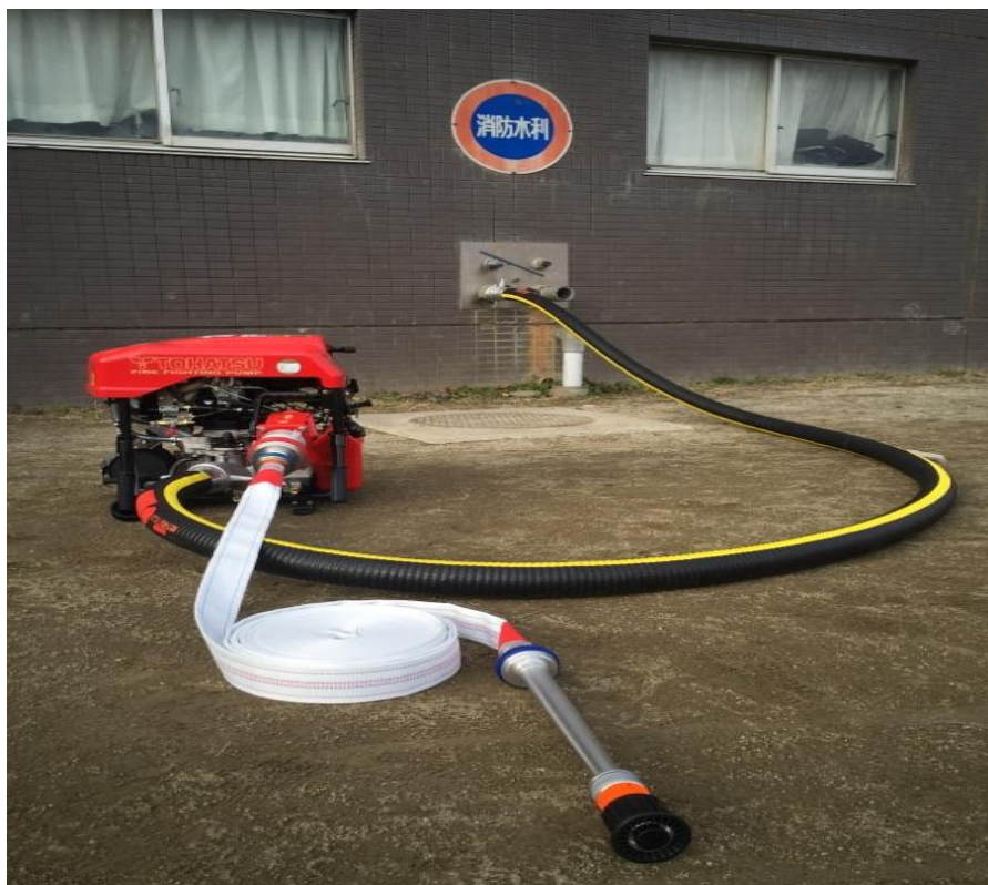
【可搬式消防ポンプ設置例】
