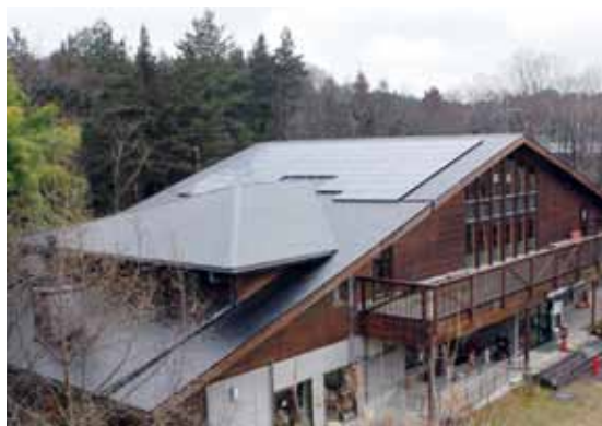
自然観察センター・しらかしのいえに設置した太陽光パネル
