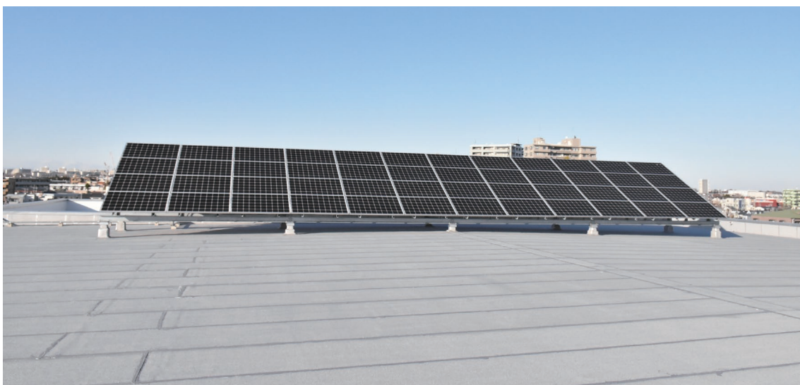
ソーラーパネル (市民交流拠点ポラリス屋上)
