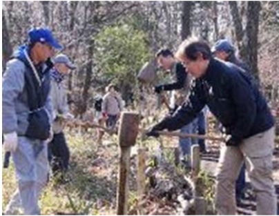
カントリーヘッジの補修
