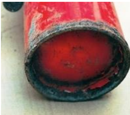
<溶接部とその周辺の腐食>
