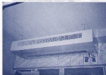
教室に設置される室内機
