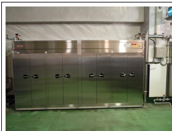
熱風消毒保管庫（中部共同調理場）
